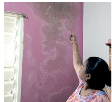
Marimala menunjukkan dinding dan siling bilik yang rosak akibat aliran air dari tingkat atas.
