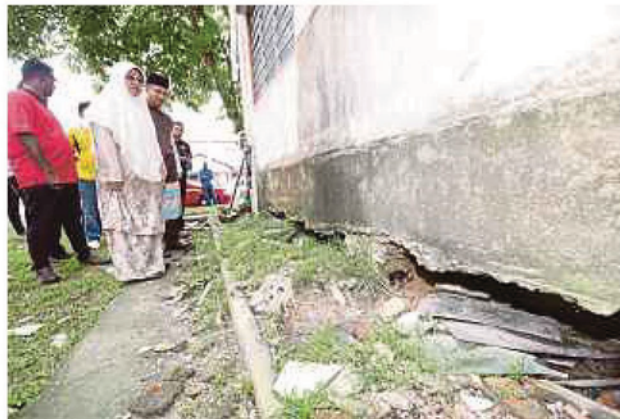
HANIZA melihat mendapan tanah di Pangsapuri Teluk Gadung Indah.
